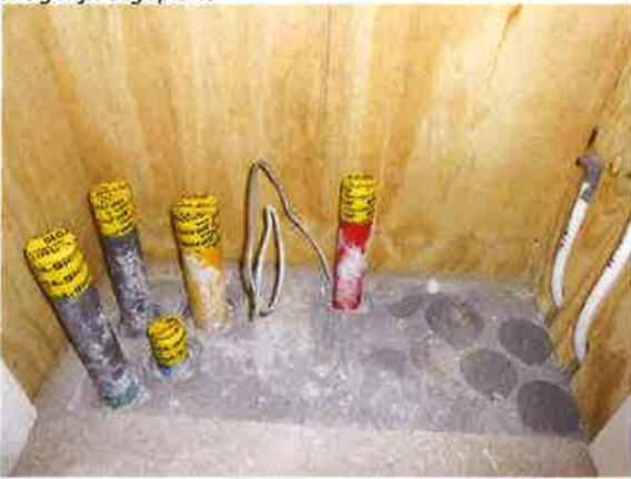
Leidingen met directe verbinding naar buiten waar mogelijk afgeplakt
