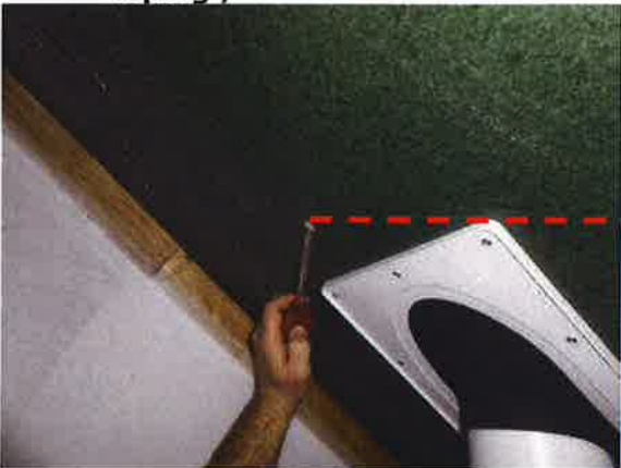
2 beschadiging dampremmer dakelement (verkeerde positie in plaat geboord)
