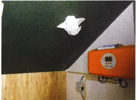
Leidingen met directe verbinding naar buiten waar mogelijk afgeplakt
